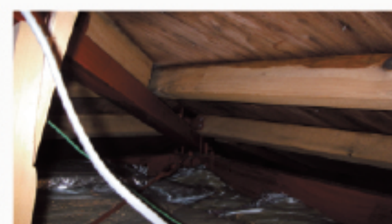
断熱材の劣化・湿潤
