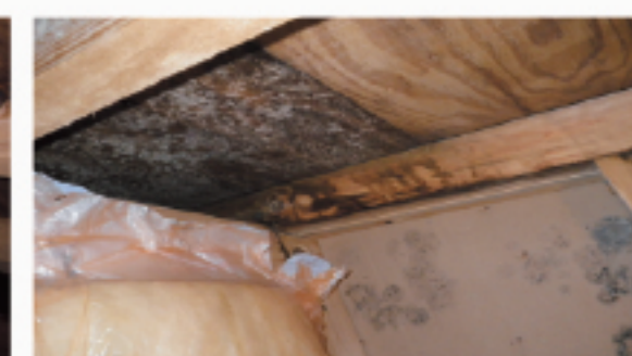
構造材の変色・腐朽
