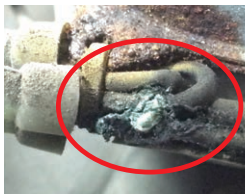
腐食・断線、発熱痕
