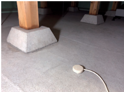
■床下漏水センサー設置事例
