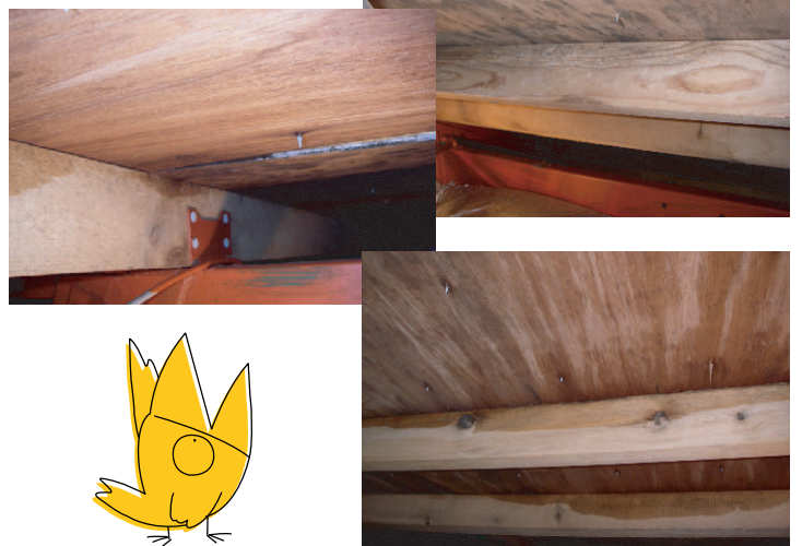
※小屋裏の結露
