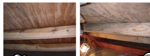
結露やカビが発生した小屋裏
